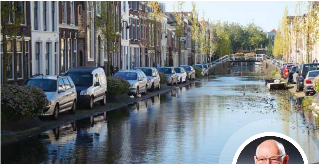
Boven: verzakkende kade in Gouda | Rechts: Sjaak Langeslag van het Hoogheemraadschap van Rijnland
